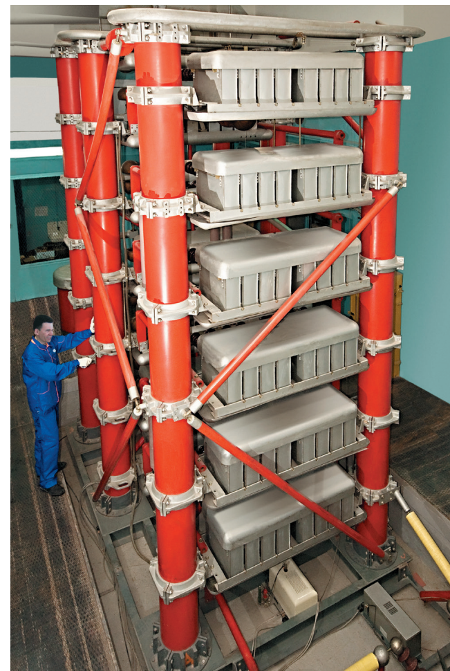
Генератор импульсных напряжений
