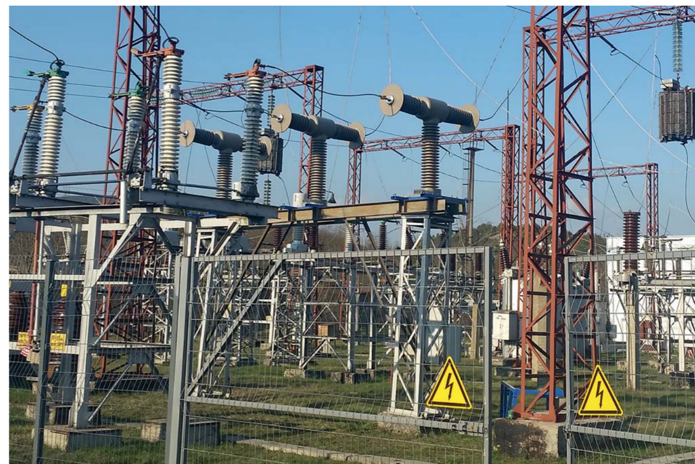
Трансформаторы тока ТОЛ-110 III УХЛ1 на подстанции
